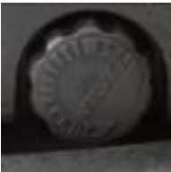
Valvola manuale per pressurizzazione
